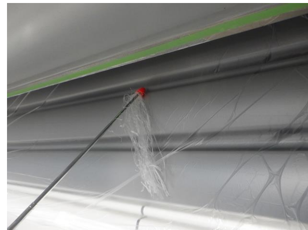
目張り実施中
