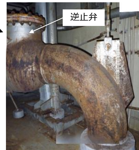
既設CUW配管
