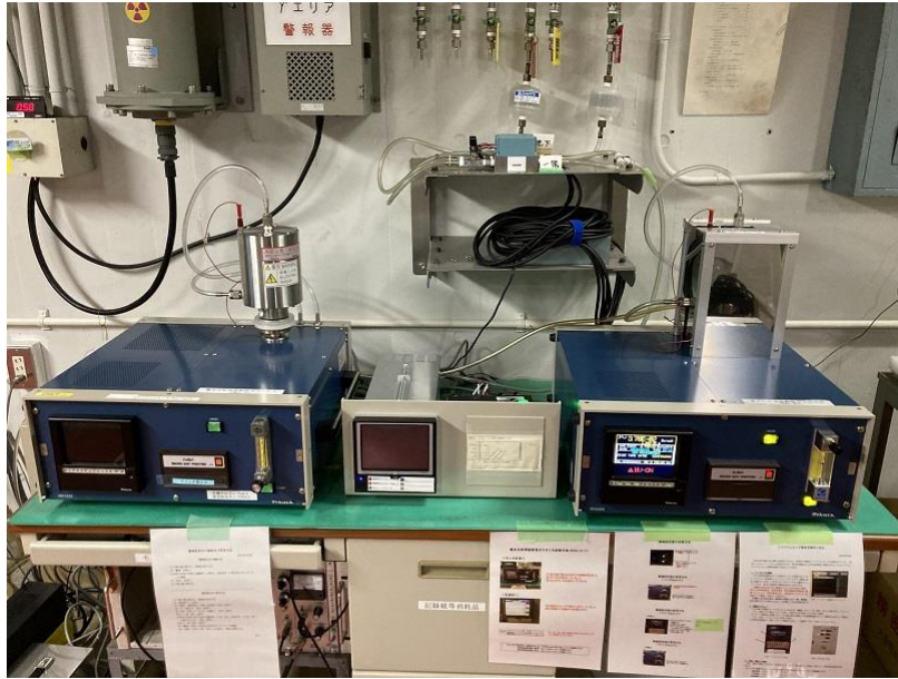
図-2 現在のモニタの設置状況
