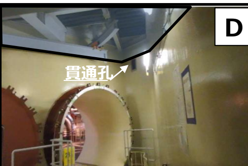
空調ダクトの貫通孔が天井付近に設置されていない小部屋（エアロック室）
