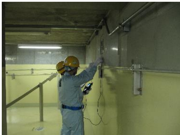
風量測定実施状況
