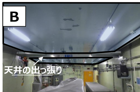
気体の移行を妨害する天井の出張り（小部屋（CRD補修室））
