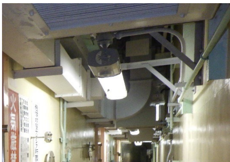
図2 防爆仕様の照明器具の例 (廃溶媒処理技術開発施設(ST))
