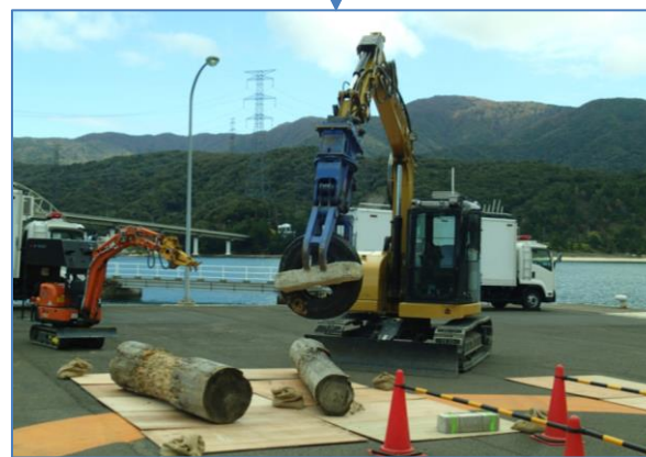
無線ヘリによる上空からの偵察結果を受けた 無線重機による瓦礫撤去
