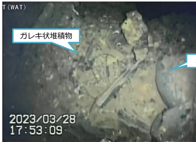
写真2.ペDESTAL内開口付近堆積物
