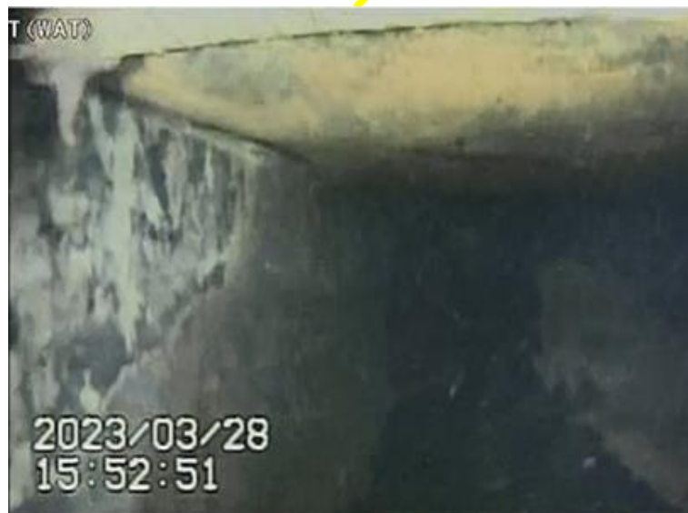
写真3 開口部内部の左側の壁の状態
