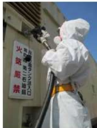
可搬型代替電源車の給油口への 接続 (コネクタ接続) (可搬型代替電源車) (屋外 T.P. 31m)
