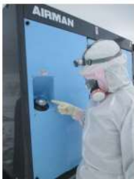
可搬型直流電源用発電機 給油口 (可搬型直流電源用発電機) (屋外 T.P. 31m)
