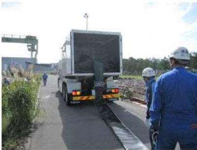
ホース延長・回収車（放水砲用） による可搬型ホース敷設 (屋外 T. P. 10. 3m)
