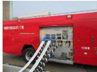
可搬型大型送水ポンプ車 周辺のホース敷設 （屋外 T. P. 10. 3m）
