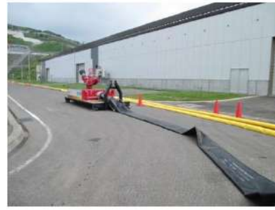
放水砲設置 (屋外 T. P. 10. 3m)
