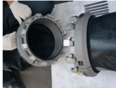
可搬型ホース(300A)接続
