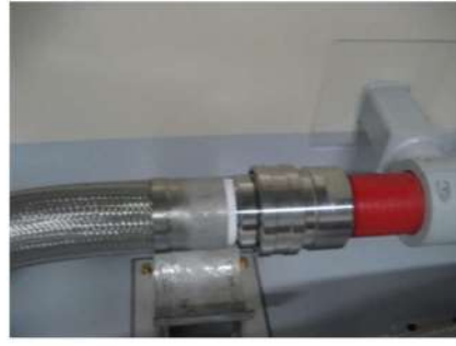
消火水系配管と 格納容器スプレイ系配管との 接続のための可搬型ホース配管接続後 (運転員(現場) B) (原子炉補助建屋 T.P. 10. 3m)
