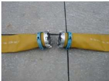
可搬型ホース（150A）接続前
