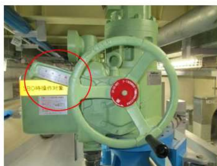
電動弁(手動操作レバー) (原子炉建屋 T.P. 21. 2m)
