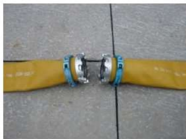
可搬型ホース（150A）接続前
