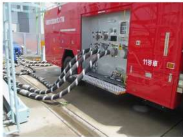
可搬型大型送水ポンプ車の設置 ポンプ車周辺のホース敷設 （屋外 T. P. 10. 3m）
