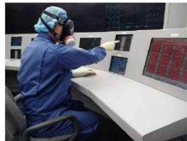
加圧器逃がし弁開操作 (中央制御室)
