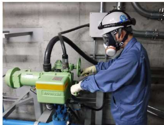
補助給水ライン流量調整 (原子炉建屋 T.P. 14. 3m)
