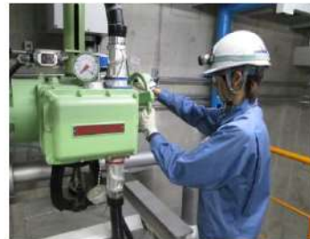
タービン動補助給水ポンプ 駆動蒸気入口弁「開」操作 （原子炉建屋 T. P. 14. 3m）
