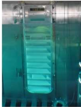
ゲートの設置状況
