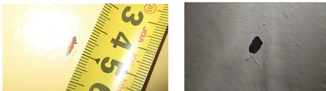
フロー②、③と判断した塗膜の劣化
