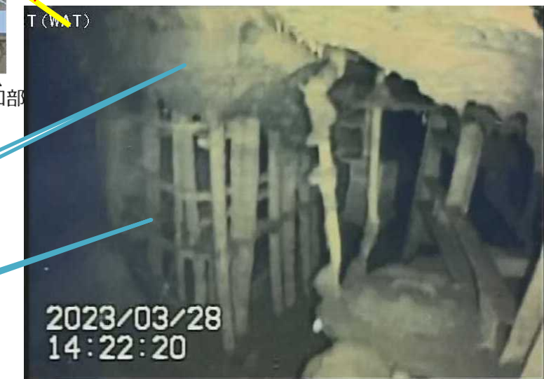
写真4.ペDESTAL開口部右下側壁面部
