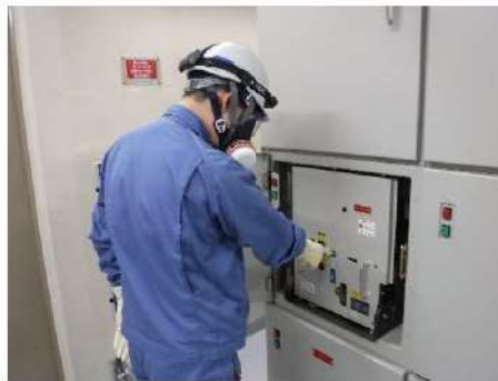
原子炉トリップ遮断器現場開放 (原子炉建屋 T.P. 17.8m)
