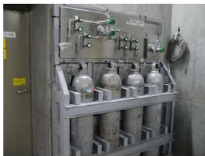
【図1 原子炉補機冷却水サージタンク加圧用可搬型窒素ガスボンベ】
