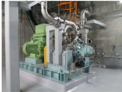
【図7 代替格納容器スプレィポンプ】
