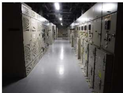
【図1 3B-安全補機開閉器室】
