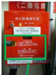
写真⑤ 消火設備操作箱
