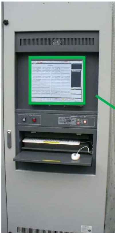
写真④ 中央制御室 総合操作盤
