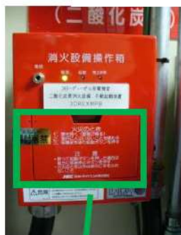
写真⑤ 消火設備操作箱
