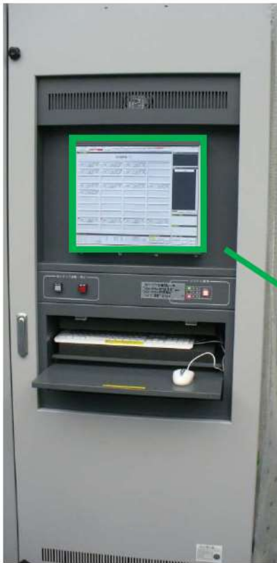
写真④ 中央制御室 総合操作盤
