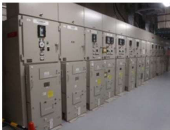
第 1-26 図：3A-安全補機開閉器室の状況
