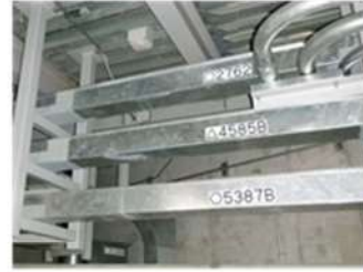
ケーブルトレイ，電線管の例
