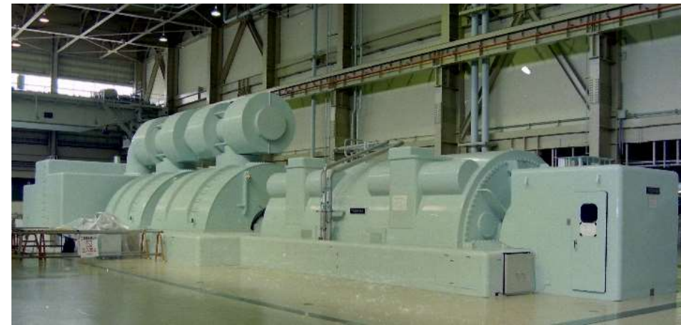
タービン発電機 (タービン建物 3階)
