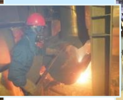
再循環ポンプマニホールド廻り
