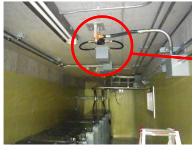
水素濃度検知器（蓄電池室の例）
