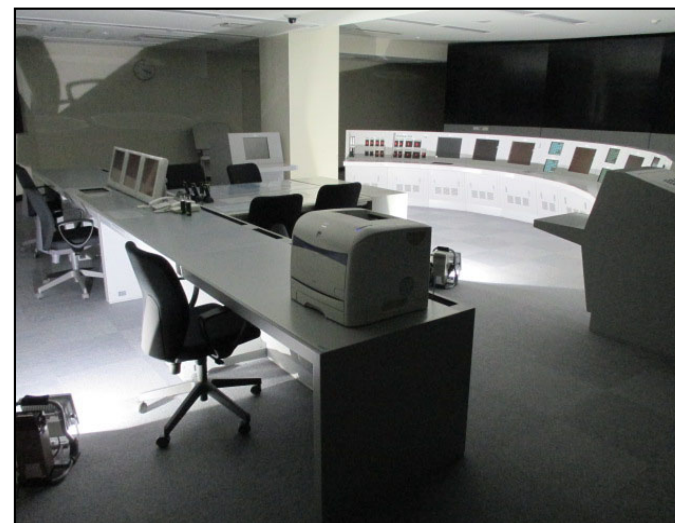
図5 シミュレータ施設における可搬型照明 (SA) 点灯状況
