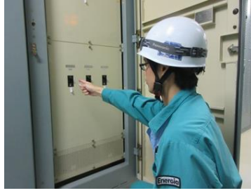
電源切替え操作
