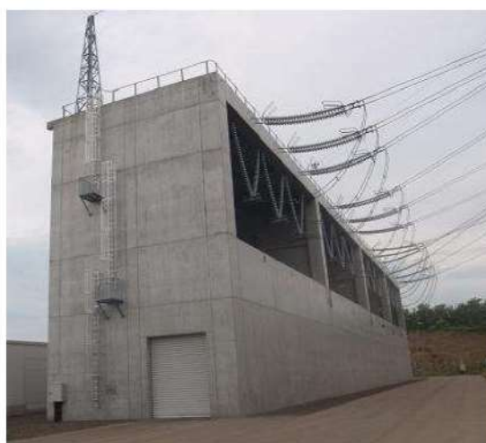
図1 開閉所（遮風建屋）
