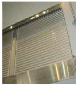
循環水ポンプ建屋外気取入口 (建屋内側)
