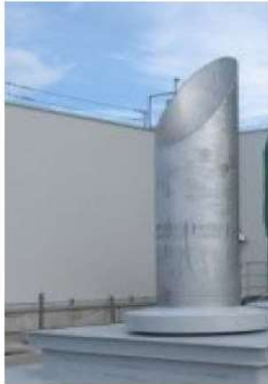
図3 主蒸気安全弁排気管の設置状況
