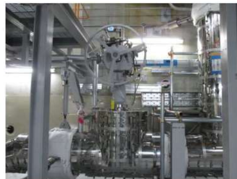
3 A-余熱除去ポンプ入口弁 (3V-RH-005A)
