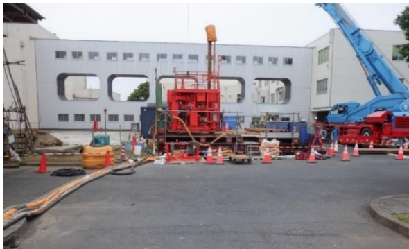
高圧噴射攪拌工法による地盤改良 (「常陽」敷地における試験施工の状況)
