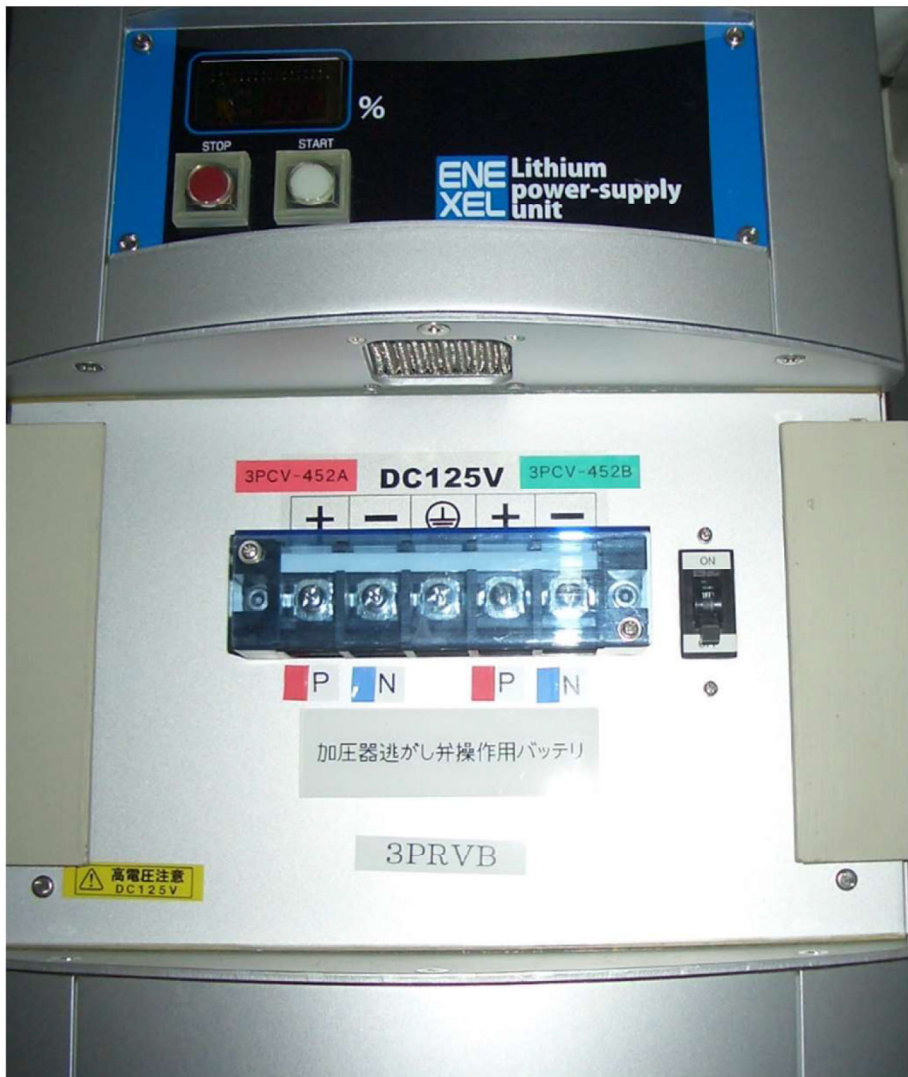
加圧器逃がし弁操作作用バッテリー 正面
