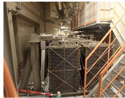
格納容器再循環サンプスクリーン
