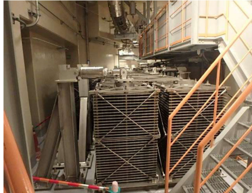
格納容器再循環サンプスクリーン
