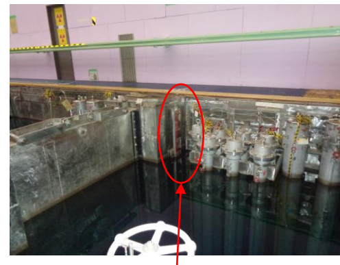
水位尺により目視での水位の監視可能
