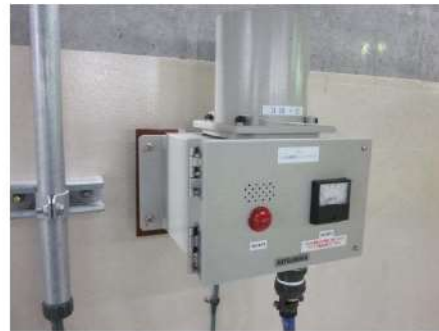
機器の固定状況
