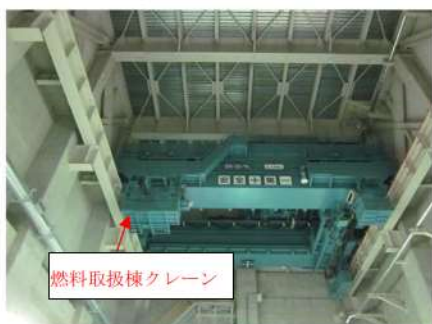
燃料取扱棟クレーン
