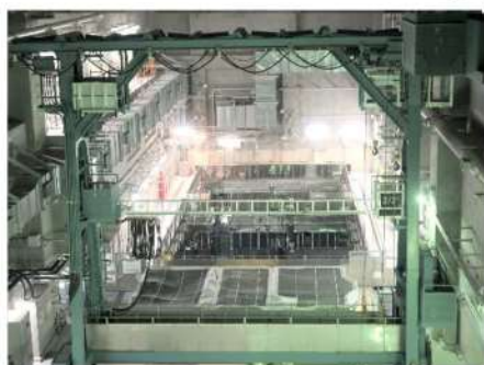
使用済燃料ピットクレーン
