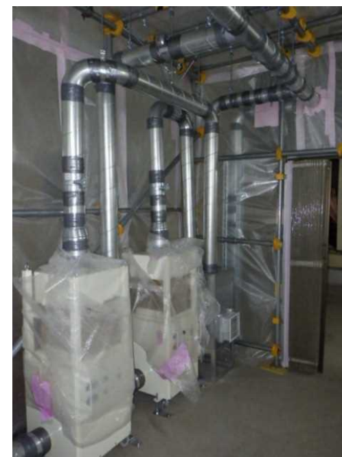
仮設局排設備の写真
