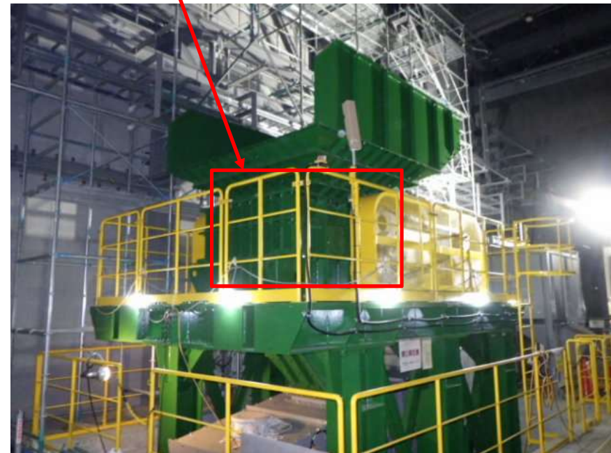
コンクリート減容処理設備
