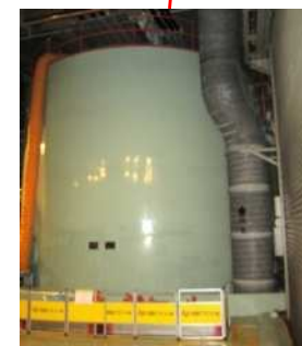
1次系純水タンク
