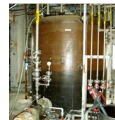
排水処理設備の例 (廃液槽)
