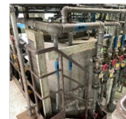
オフガス処理設備の例 (スクラバ)
