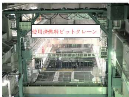
使用済燃料ピットクレーン
