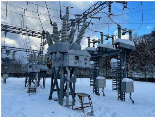
国富変電所（GCB）
