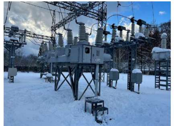
国富変電所（VCB）
