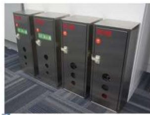
消火器の設置状況
