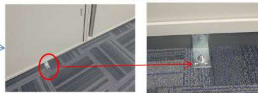
運転指令卓後ろの キャビネットの固定状況
