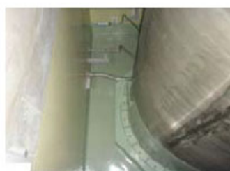
(②廃樹脂供給タンク 下部)
