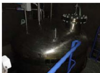
(①廃樹脂供給タンク 上部)
