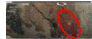
コア切り出し後の写真 右ブロック採取箇所
