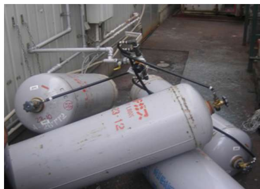
図 東日本大震災でのLPガスボンベの被災状況※
