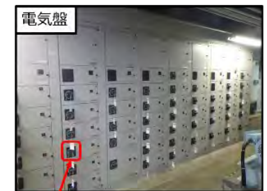
(2) 電気品の隔離方法
