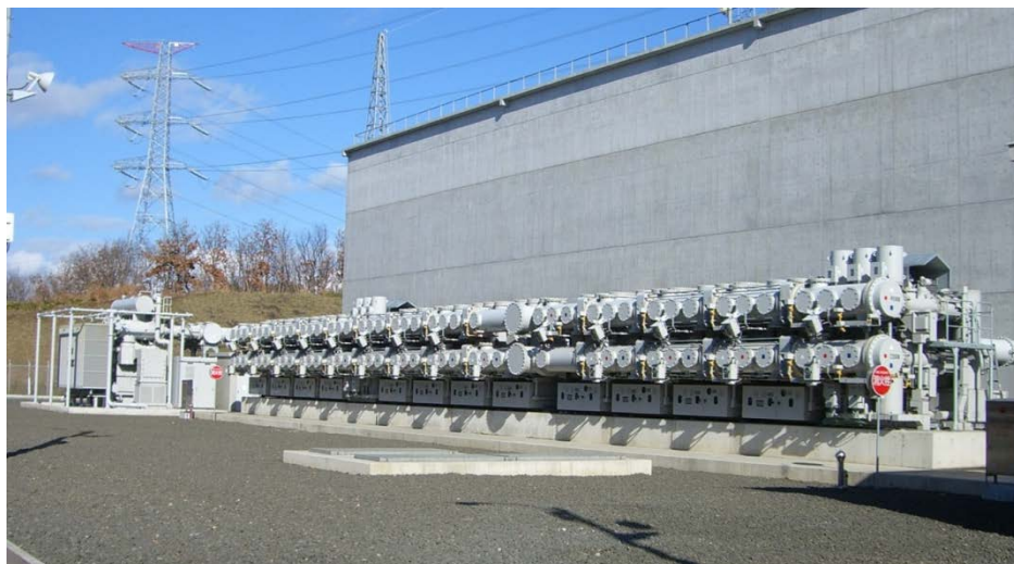
開閉所 275kVガス絶縁開閉装置
