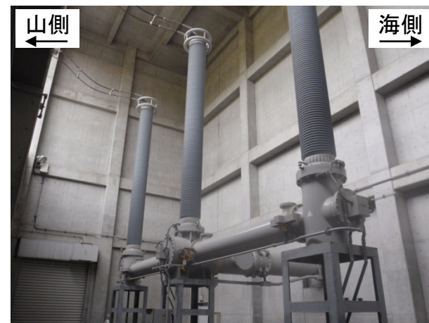
ポリマー碍管（遮風建屋内）
