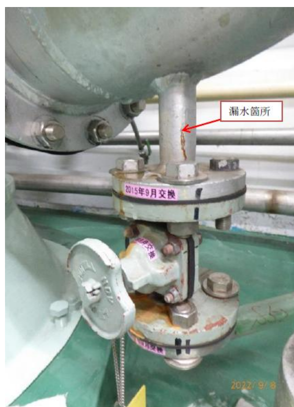
図5 ドレン配管及び漏水箇所
