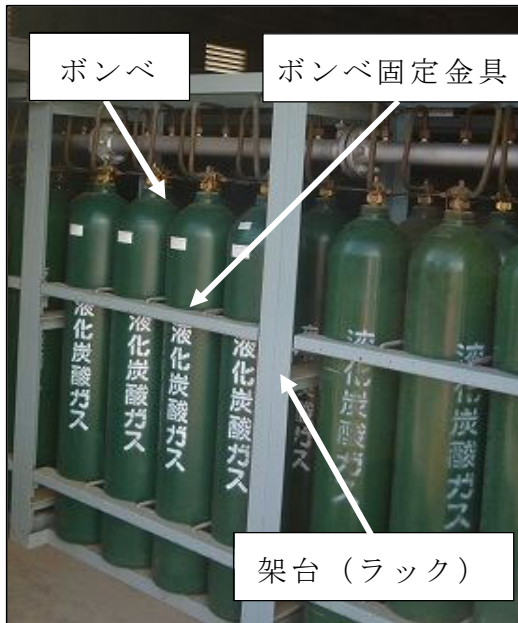
【二酸化炭素消火薬剤貯蔵容器室】 二酸化炭素ポンベ
