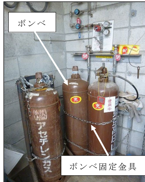
【ポンベ庫】 アセチレンポンベ
