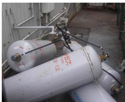
東日本大震災でのLPガスボンベの被災状況の一例 3)
