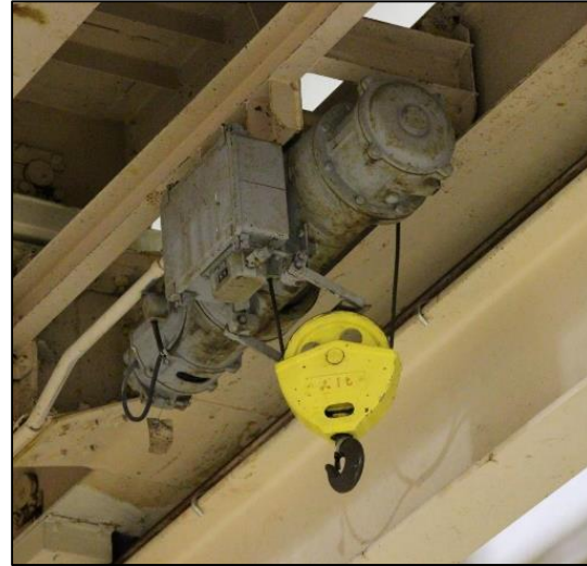
⑬クレーン設備
