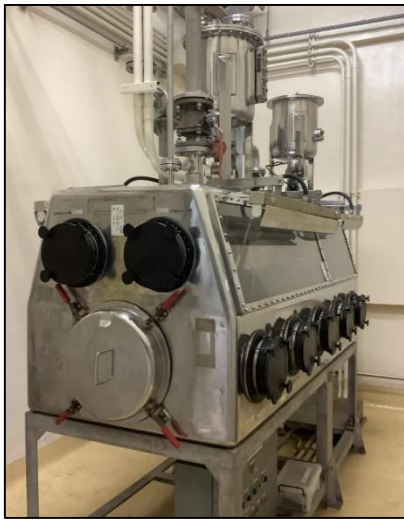
⑨No.11グローブボックス (廃液処理装置)
