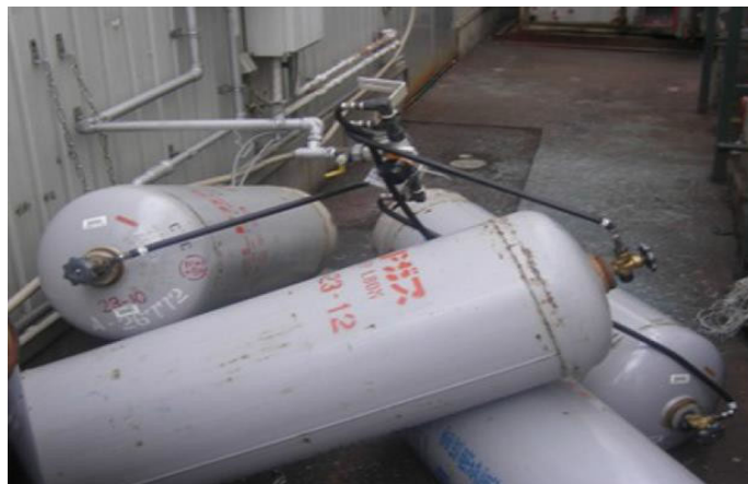
図17 東日本大震災のLPガスボンベの被災状況
