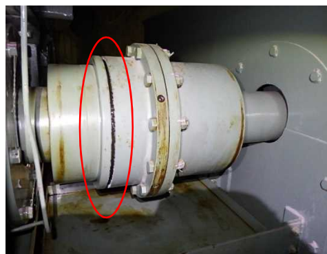
ギアカップリングカバー損傷部
